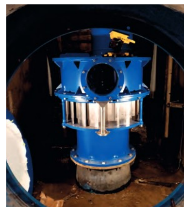
Průhled na instalované soustrojí prototypu ze strojovny do turbínové kašny
